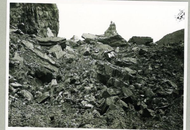
Modigliana - frana di Cà Risanello
